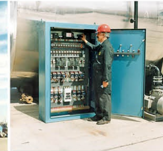
تابلوی برق کاملاً اتومات سیستمهای کنترل و ایمنی دیگ Automatic switchboard of safety and controllers system
