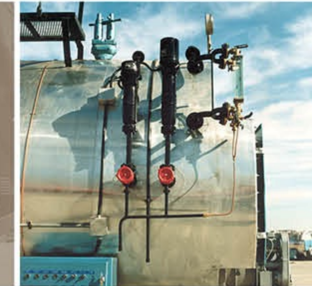
شیر اطمینان، آب و تجهیزات کنترل سطح آب Safety valve, water indicator, water level controllers
